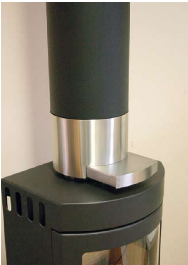
Katalysatorn är monterad i rökröret.
